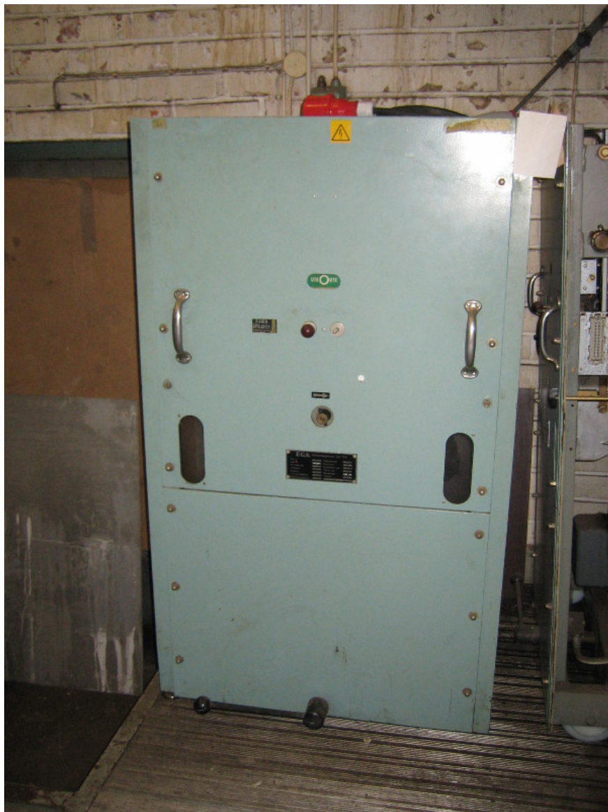
EGA 3kV vähäöljy
