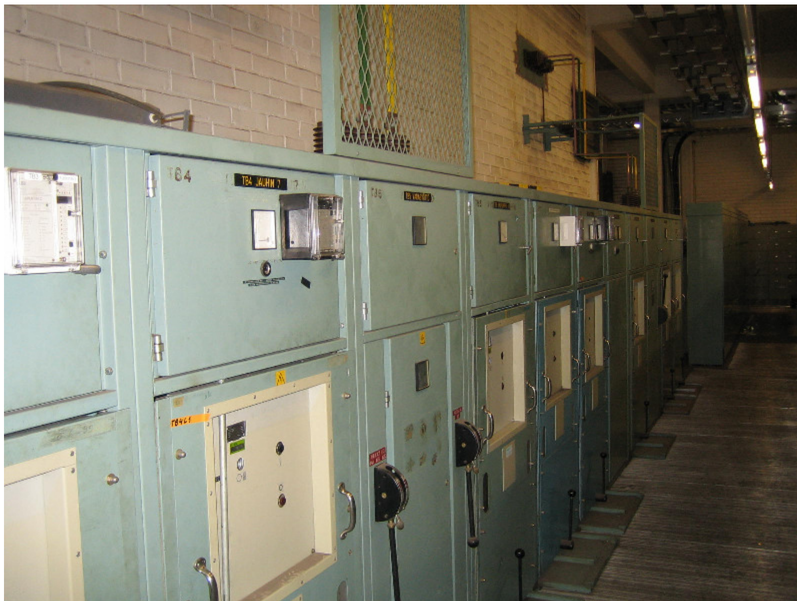
EGA:n 3kV-kojeistoa (katkaisijat uudet Siemensin tyhjöt)
