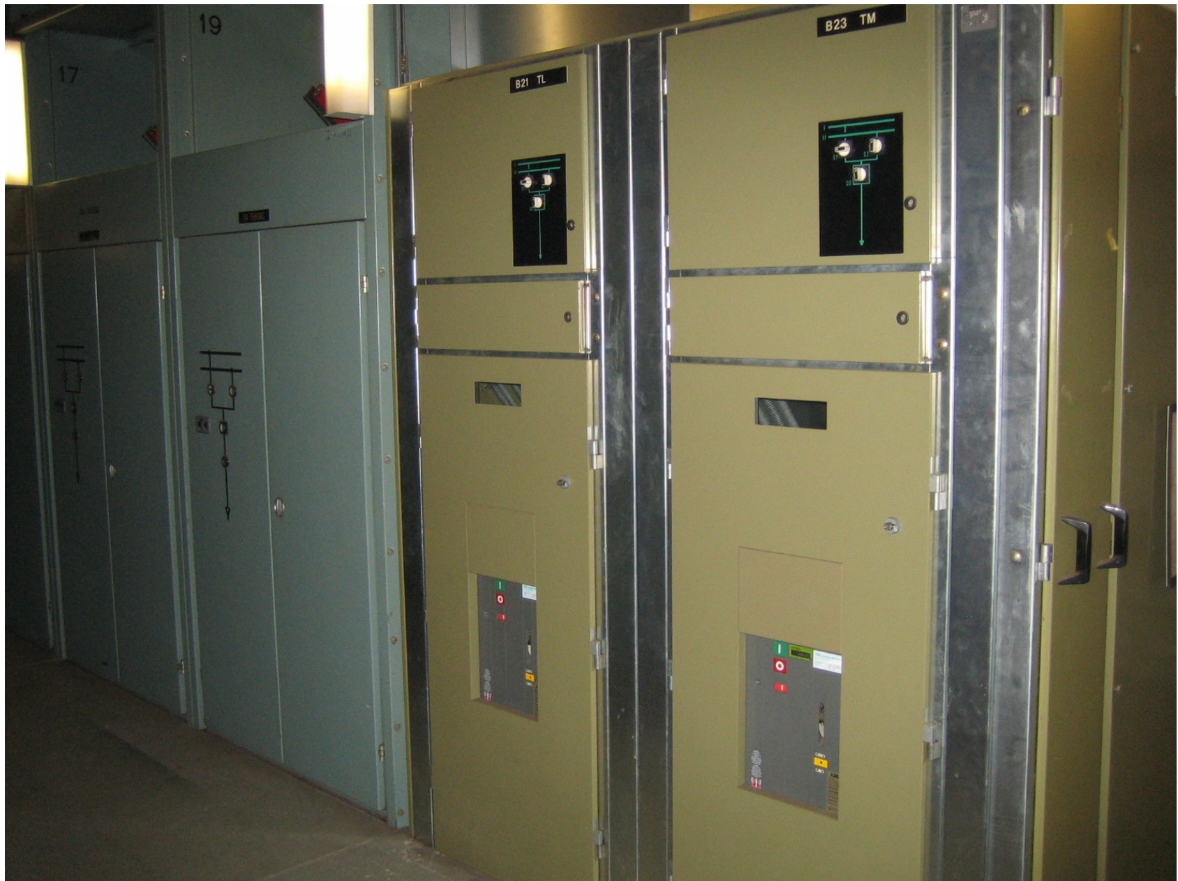
ABB:n 10kV-kojeistoa vm. 96
