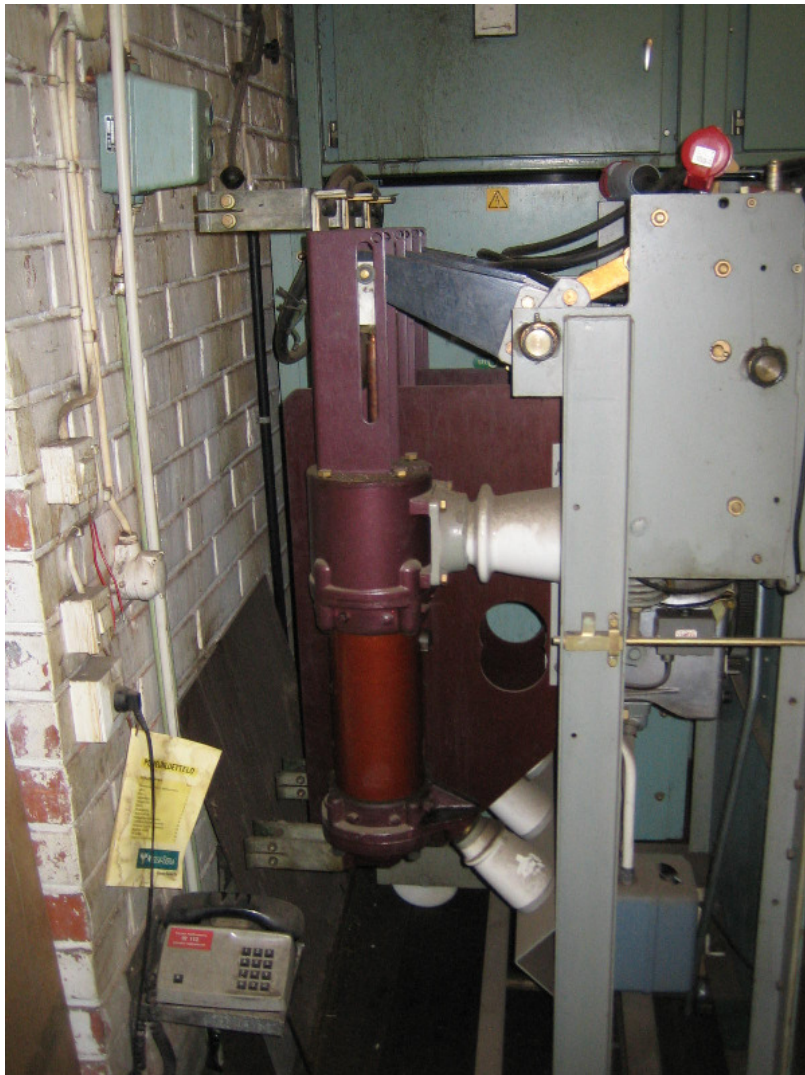
EGA 3kV vähäöljy
